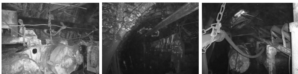
Rys. 16.1 Widok fragmentów przenośnika taśmowego w warunkach dołowych
