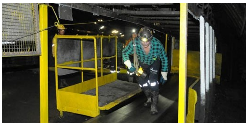
Rys. 53.4 Pomost do wsiadania na taśmę dolną przenośnika taśmowego
