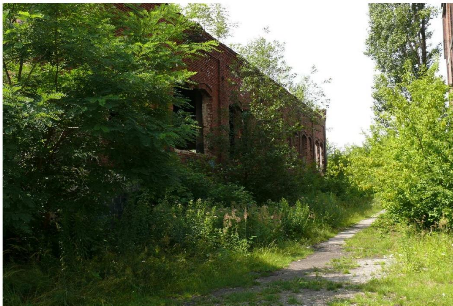
Fot. 8: Ruiny budynków po warsztatach remontowych w rejonie ul. Mjr. Hubala-Dobrzańskiego - KWK Klimontów w Sosnowcu (Ruch III Klimontów). Widoczna zaawansowana ekspansja krzewiastej i drzewiastej roślinności ruderalnej
