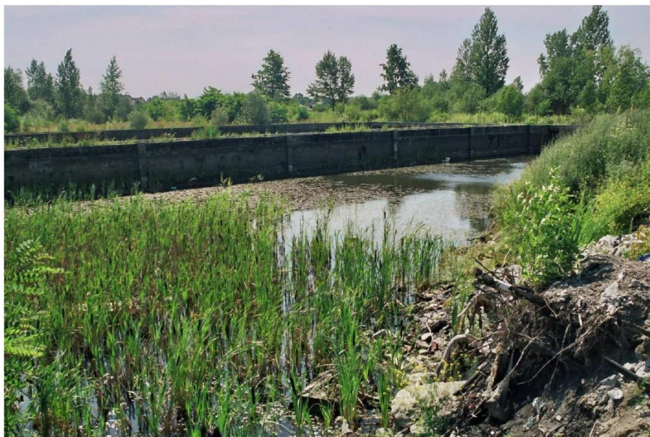
Fot. 5: Wypełnione wodą opadową nieczynne, betonowe osadniki z zaawansowaną sukcesją roślinności błotnej i wodnej w rejonie ul. 3-go Maja - KWK Sosnowiec
